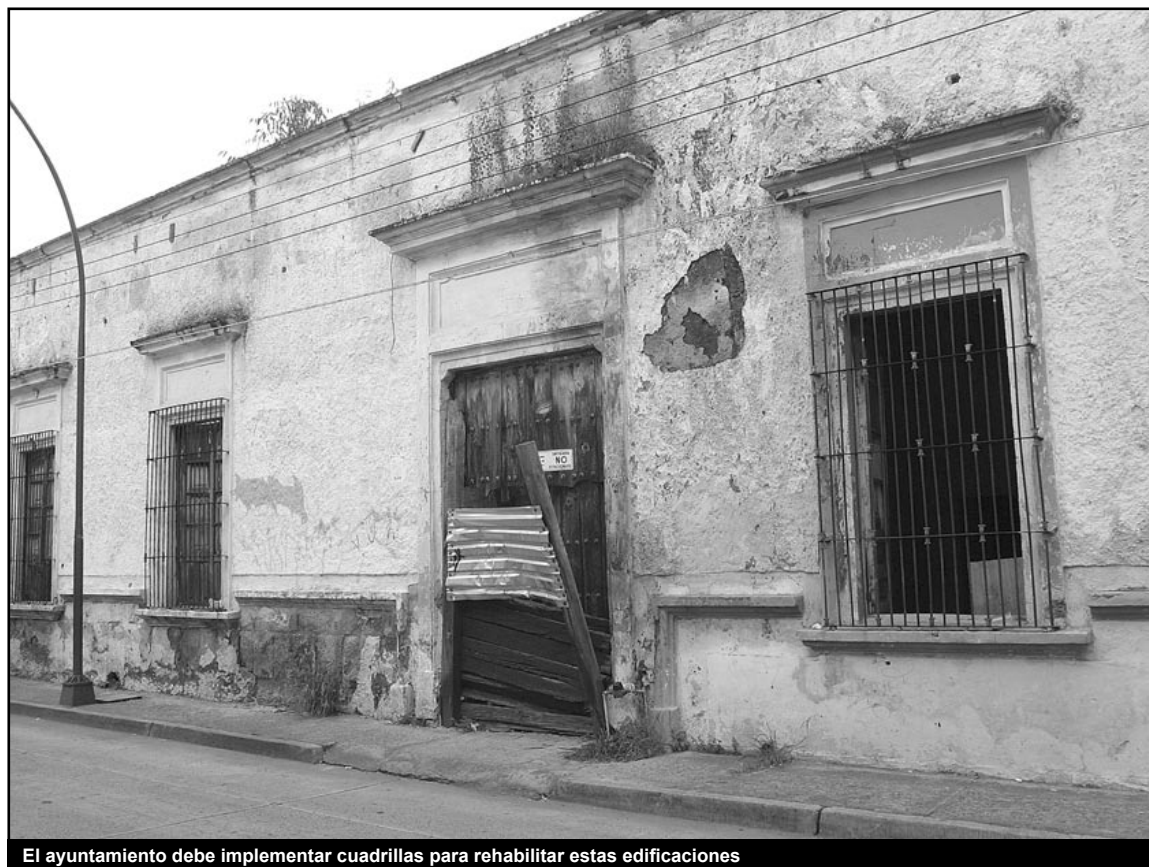
El ayuntamiento debe implementar cuadrillas para rehabilitar estas edificaciones
