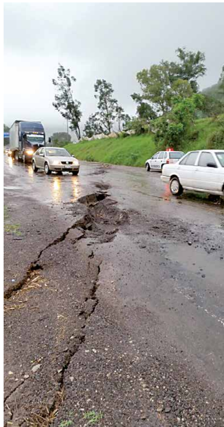
Grietas a la entrada de Ciudad Guzmán. / FOTO: RAÚL AGUILAR LARES
